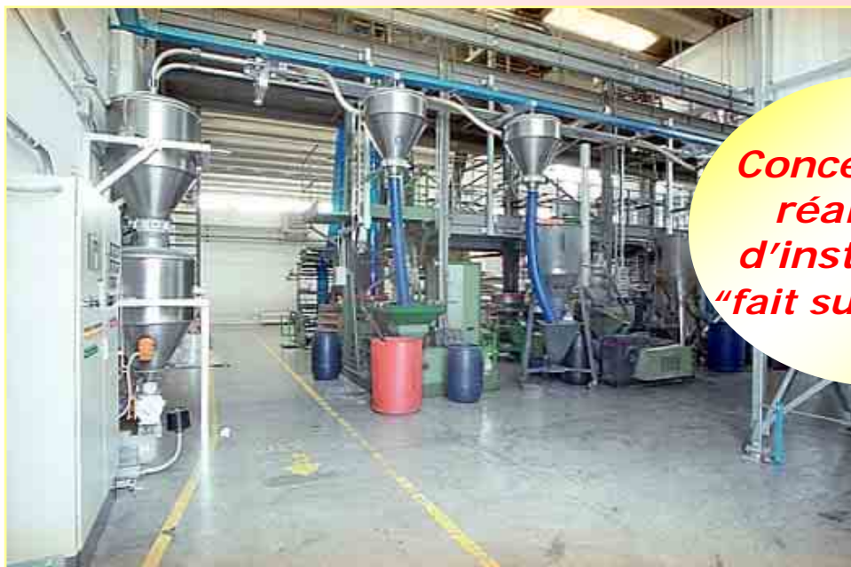
Installation de dosage automatique pour la production de sacs et emballage en matériel plastique
