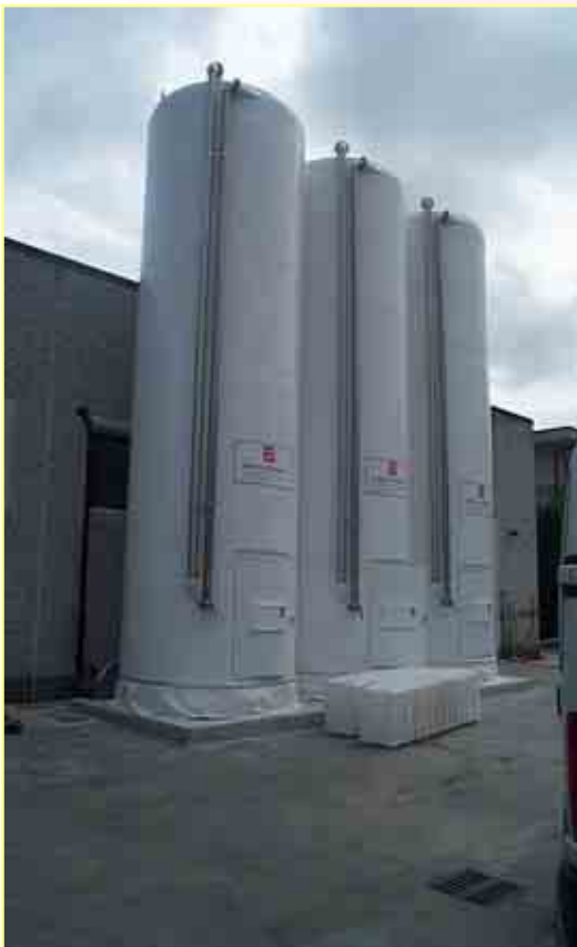
Stockage de 40 tonnes de farine dans 3 silos en fibre de verre PVRF avec système de pesage sur cellule de chargement installé à Cepagatti (PE).
