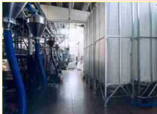
Installation avec prélèvement du produit depuis plusieurs endroits.
