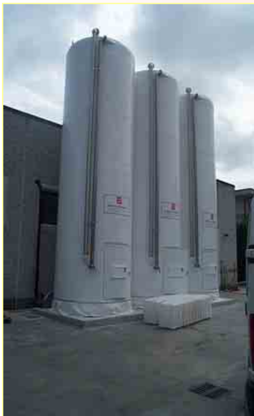
Stoccaggio da 40 tonnellate di farina in 3 silos di vetroresina PVRF con sistema di pesatura su celle di carico installato a Cepagatti (PE).
