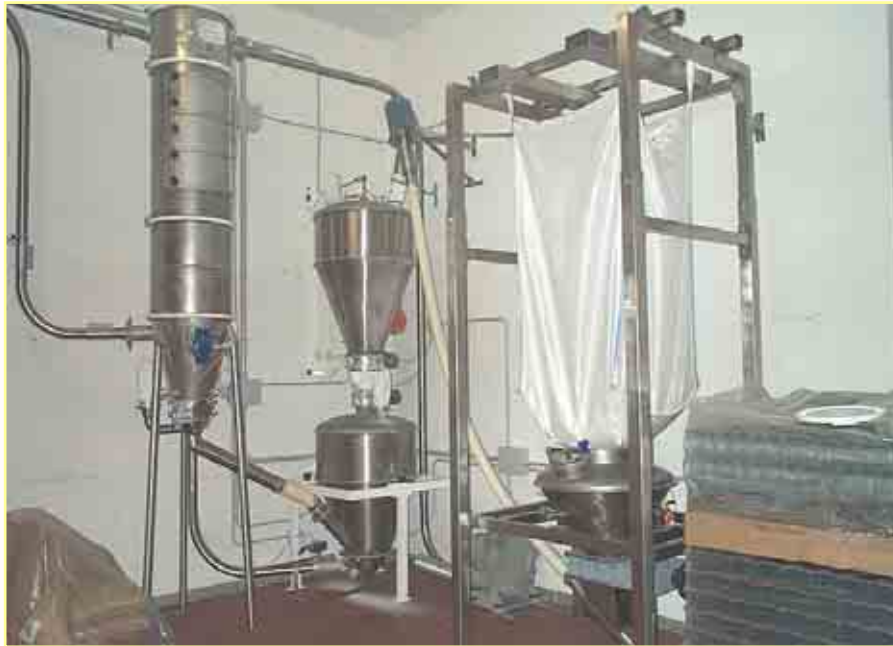
Estacion vacia Big Bag para la automatizacion del azucar intalada en Lovere(So) en una fabrica productora de marmelada.
